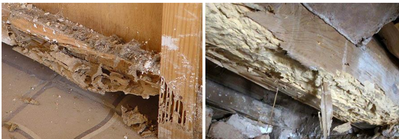
Fotografía izquierda: Galerías y "barro" seco de termitas subterráneas, Fotografía derecha: Galerías de carcoma grande
